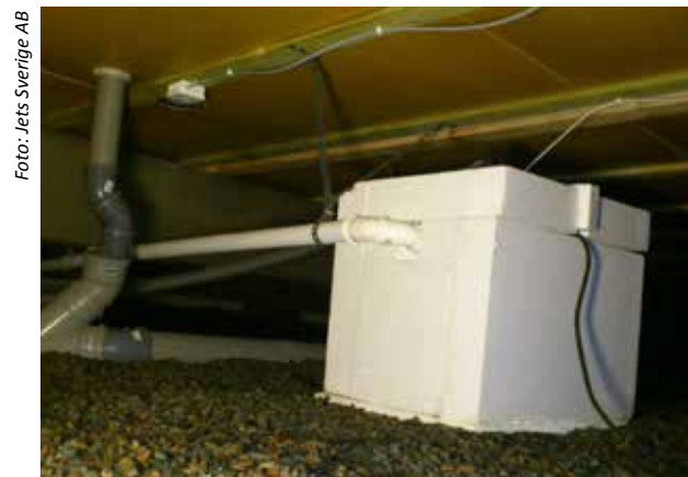
Isolerad vakuumenhet i krypgrund.
